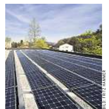
Die Fotovoltaikanlage des Kirchenzentrums Glaubten
